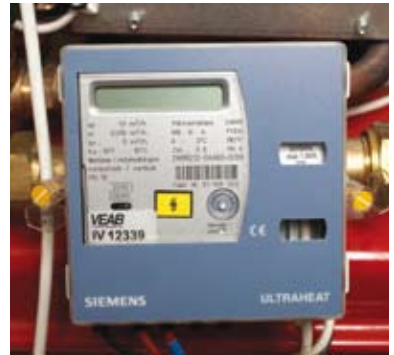
Energimätare (tillhör VEAB)
